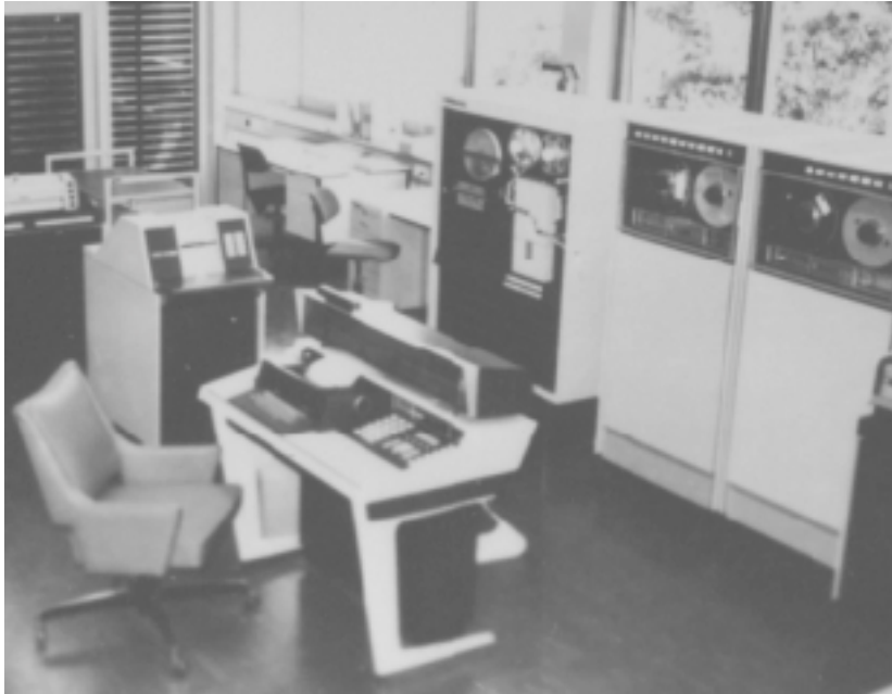
Blick auf die CD3300 im Keller des Philosophiegebäudes
